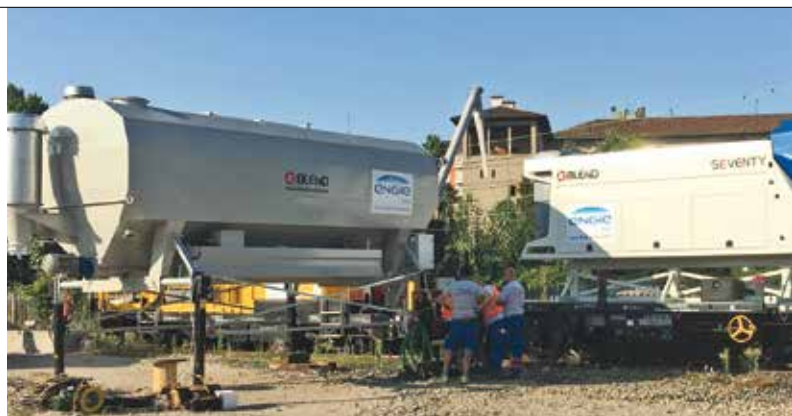
10. L'accoppiata fra impianti montati su materiale rotabile e silos orizzontali permette di aumentare ulteriormente l'efficienza operativa velocizzando le operazioni e aumentando l'autonomia
