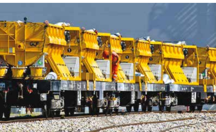
9. Nel cantiere della costruzione del tunnel di base del Monte Ceneri per GCF, la Blend Plants ha risolto in modo brillante e veloce le problematiche di getto grazie ai propri mescolatori
