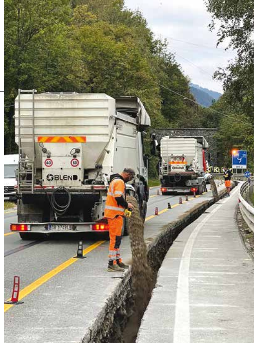
5. Le due Blend Seventy della Edilgrimaldi al lavoro durante la posa di tubazioni: i due impianti hanno reso più rapidi ed efficienti i lavori stradali svolti dall'Azienda di Bardonecchia
